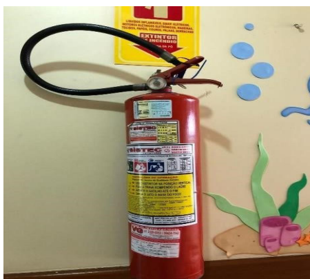
Extintores devidamente instalado- Fotografia
