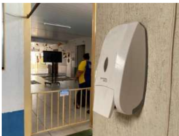
Dispenser de álcool no refeitório - fotografia
