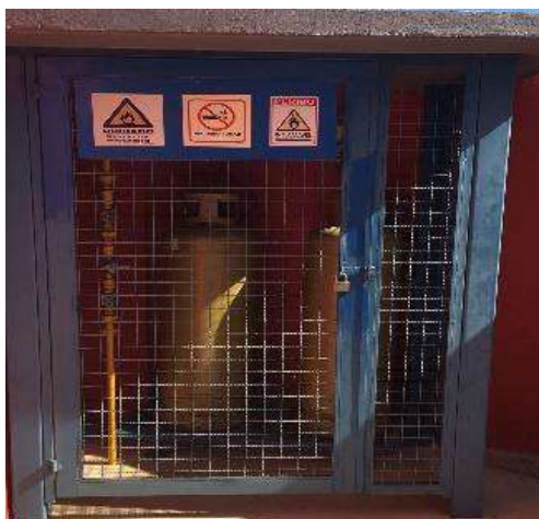
Abastecimento de gás
