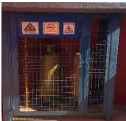
Abastecimento de gás
