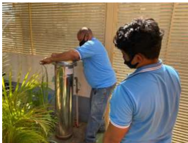
Manutenção do filtro central realizada em março de 2023 - fotografia
