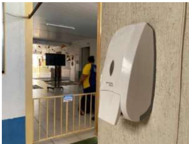
Dispenser de álcool no refeitório - fotografia
