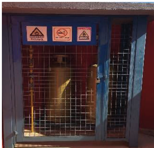
Abastecimento de gás
